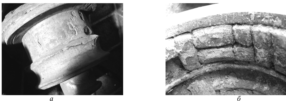
а – руйнування опори; б – розворот і руйнування роликів Рисунок 2 – Руйнування роликового підшипника
