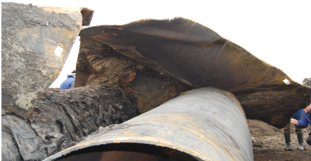
Рис. 1. Аварія з розривом трубопроводу на повне січення
