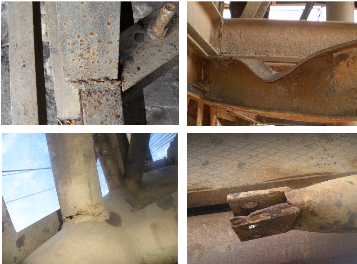
Рисунок 5 – Характерні дефекти металоконструкцій бурових веж
