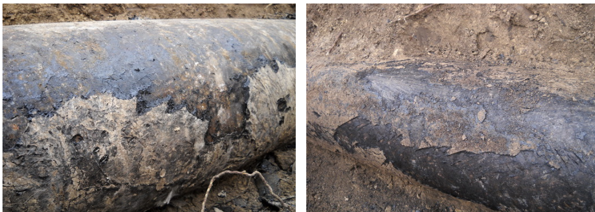
Рисунок 3 – Приклади руйнування ізоляційного покриття на підземній ділянці трубопроводу з великою площею пошкодження
