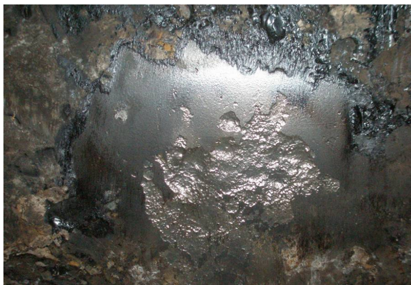
Рисунок 4 – Локалізоване електрокорозійне ураження основного металу магістрального газопроводу
