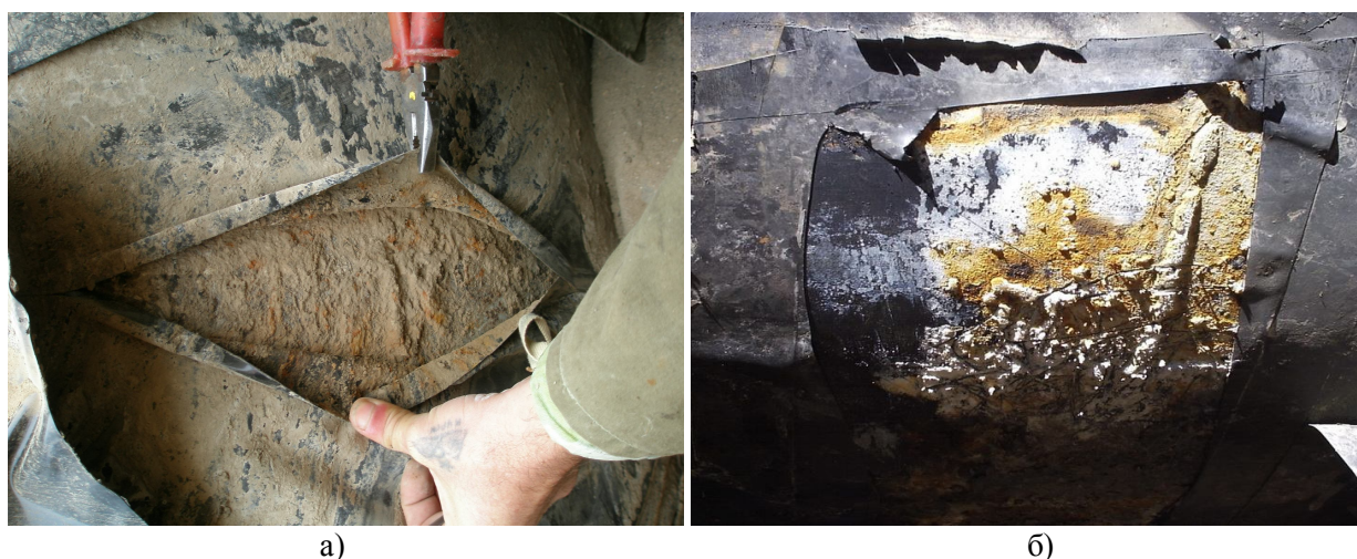
Рисунок 8 – Приклади відшарування ізоляційного покриття підземного нафтопроводу із корозійними пошкодженнями основного металу труби
