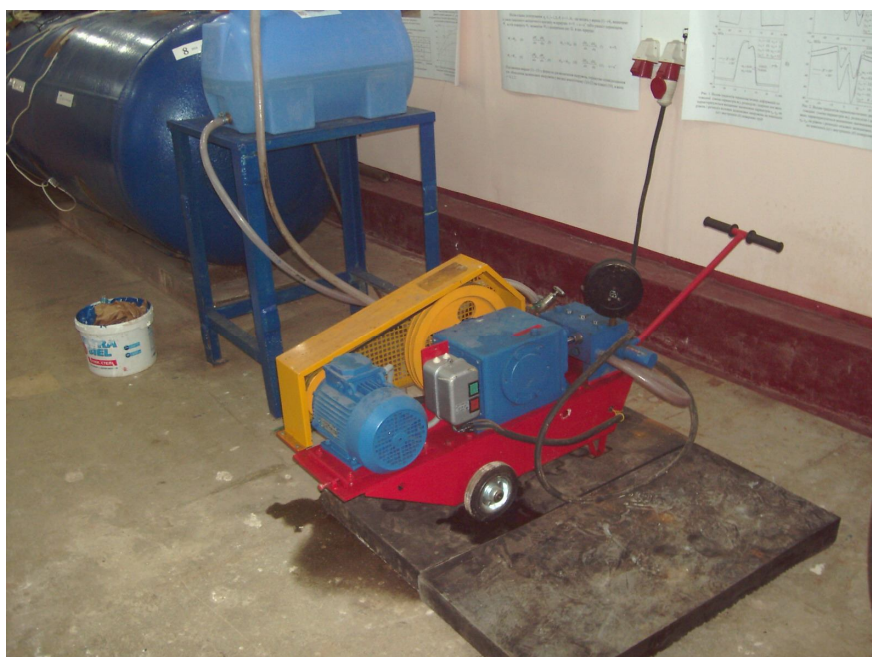
Рисунок 4 – Насосна станція дослідницького стенду
