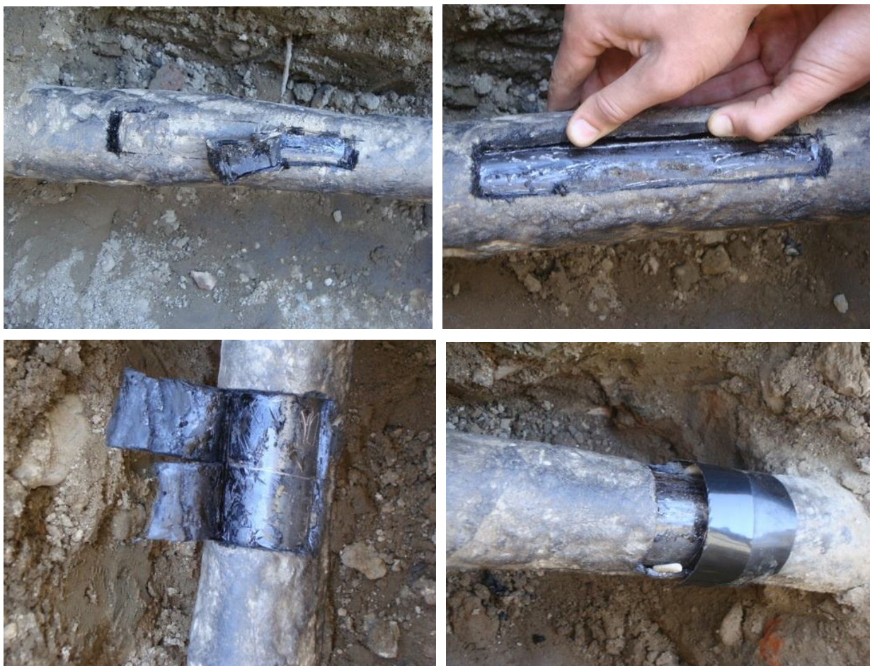
Рисунок 2 – Створені відшарування ізоляційного покриття
