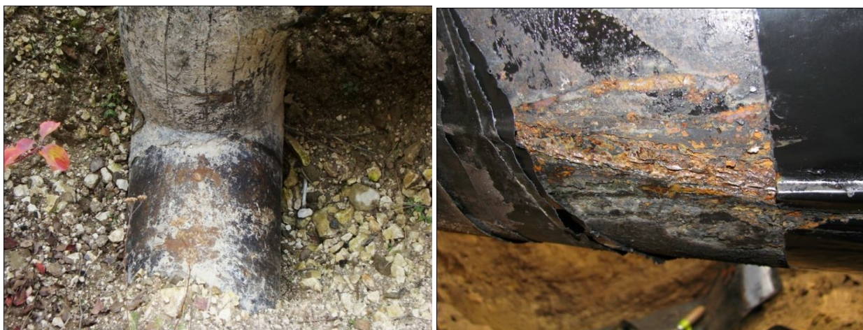
а) наскрізний дефект; б) відшарування ізоляції
