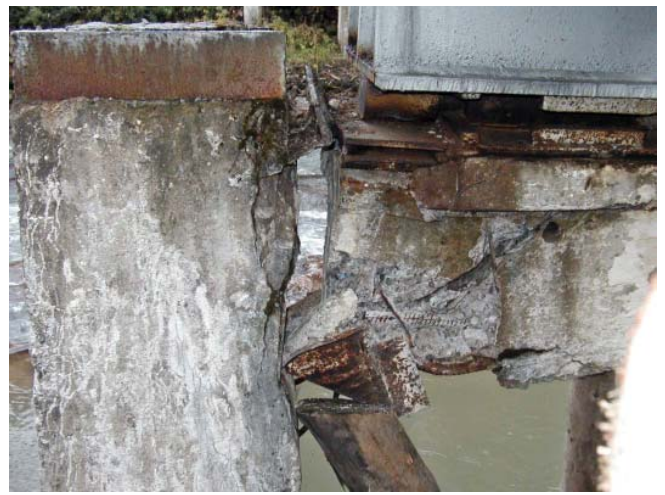
Рис. 2. Руйнування опорного вузла другої опори нафтопроводу D = 720 мм
