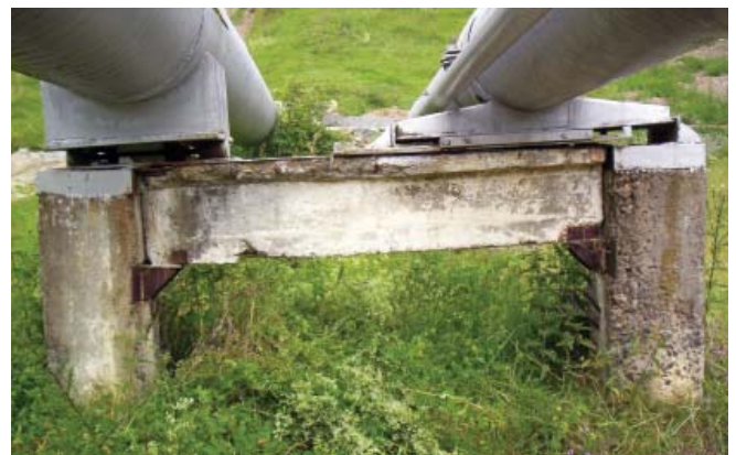
Рис. 5. Загальний вигляд опорного вузла нафтопроводу D = 720 мм, стілик якого опирається на сток і ригель
