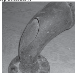
Рисунок 5 – Результати ерозії-корозії на згинах трубопроводу природного газу
