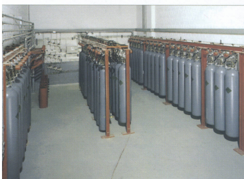
Рисунок 4 — Установка газового пожежогасіння (CO 2 ) високого тиску
