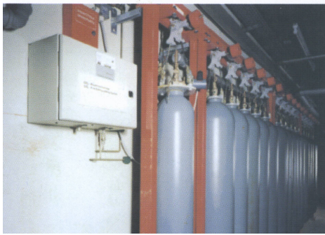
Рисунок 3 — Установка газового пожежогасіння (CO 2 ) високого тиску з пневматичним пристроєм затримки часу
