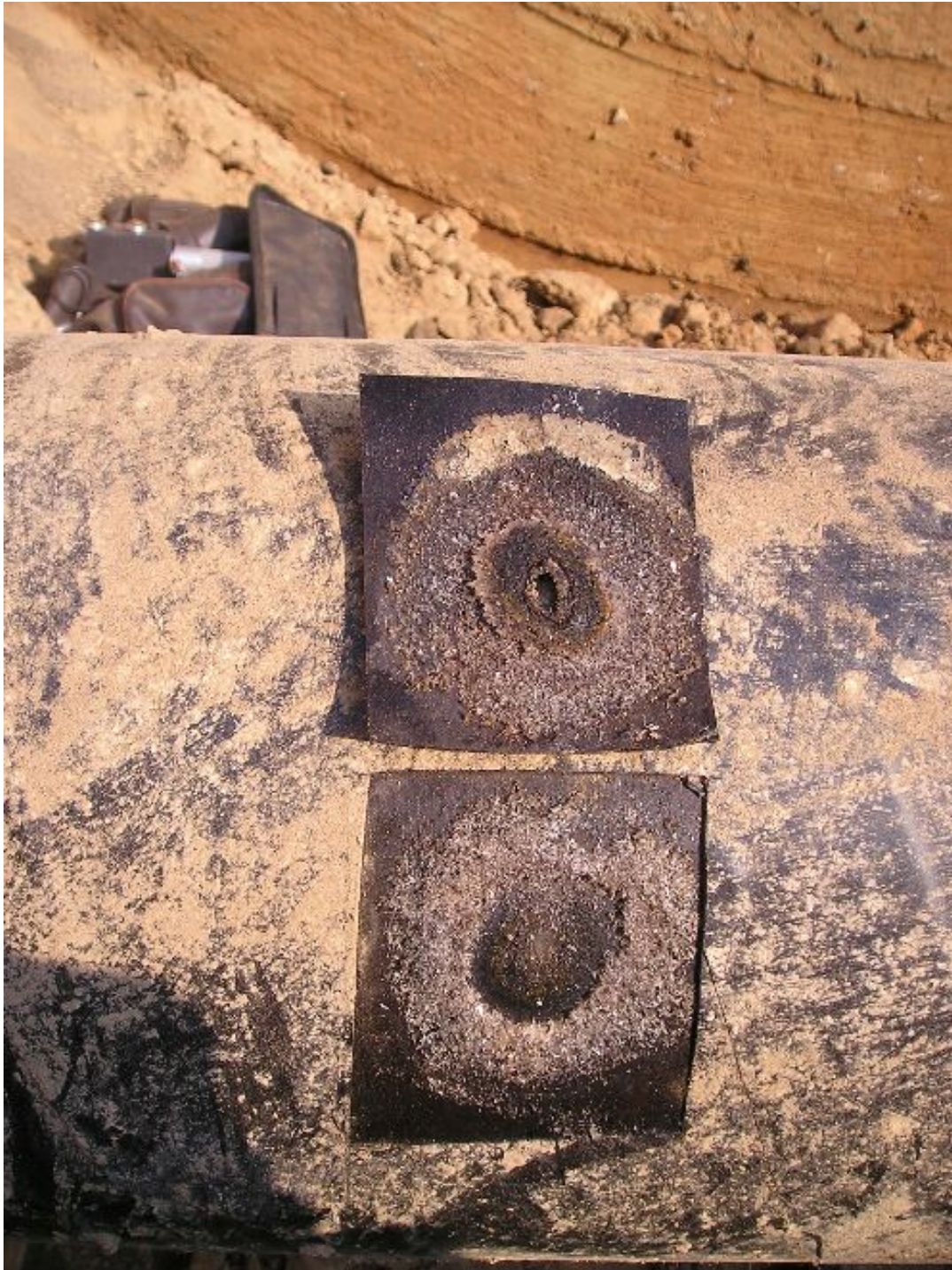
Рисунок 1 — Зовнішній вигляд ділянки пошкодження ізоляції, вкритої кристалічними продуктами корозії у вигляді “кратера” (ізоляційне покриття знято)
