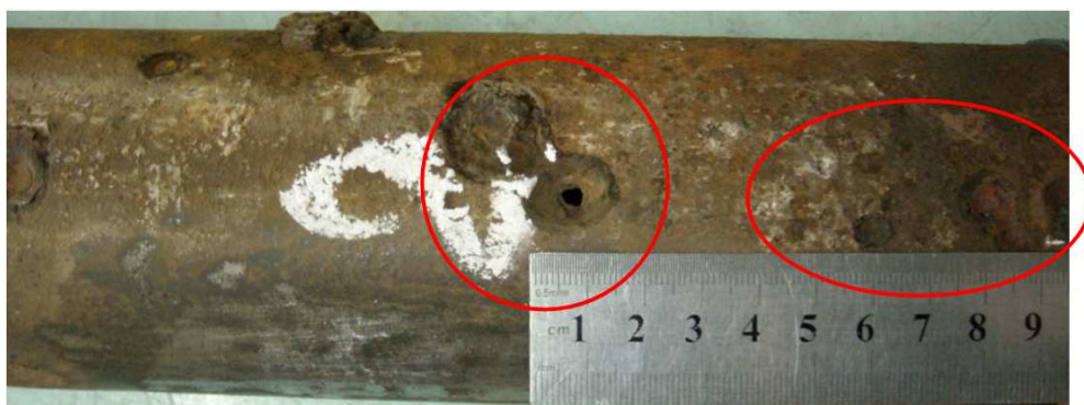
в) локальні корозійні каверни з наскрізним дефектом діаметром 3 мм;
