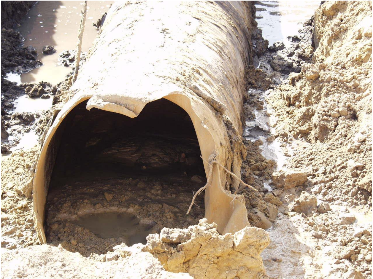
Рисунок 1.3 - Фрагмент аварії на газопроводі “Новопсков-Акай-Моздок”
