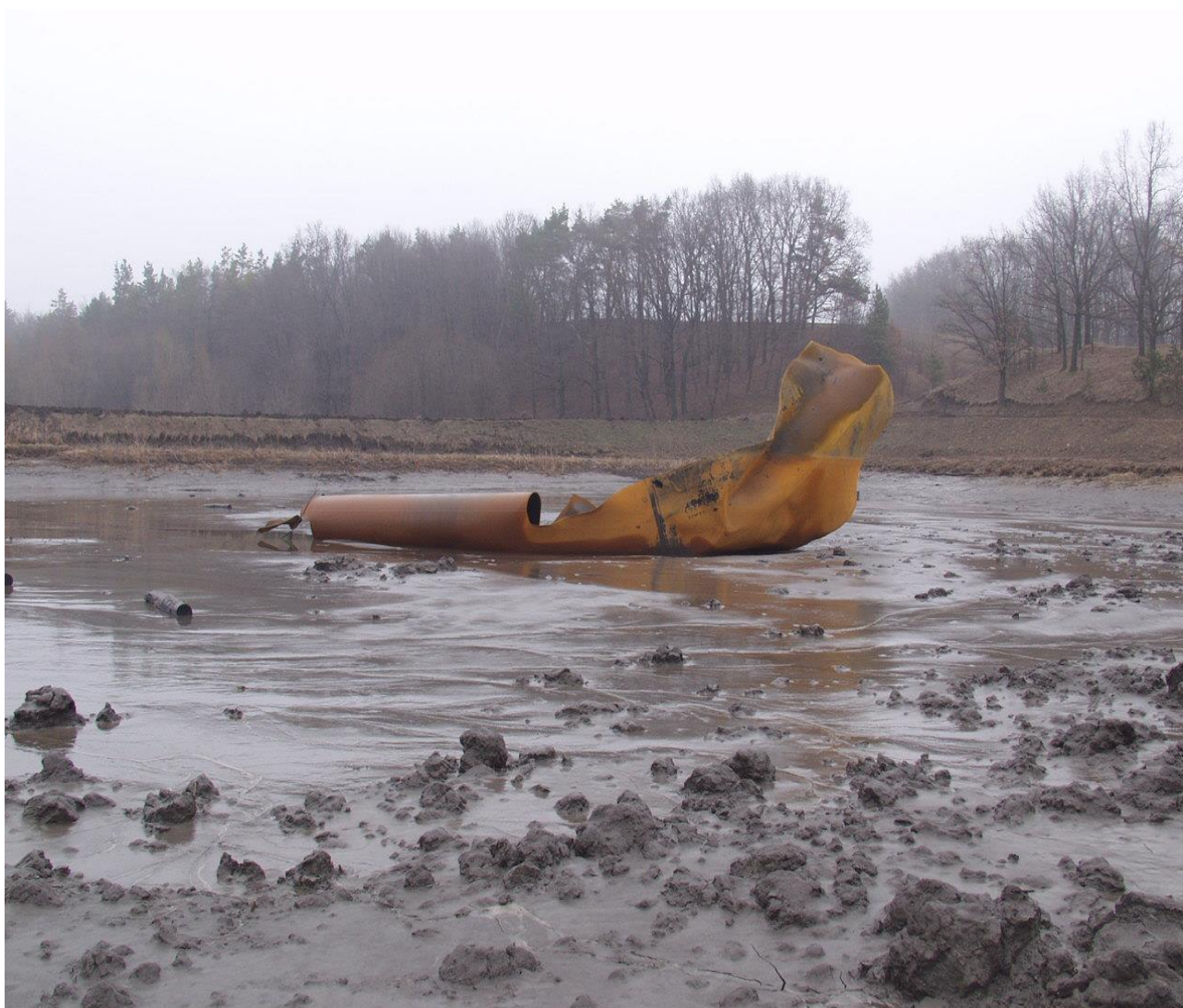
Рисунок 2.2 - Лавинне руйнування магістрального газопровода УПУ із сталі 17Г1С, довжина руйнування складає 373 м
