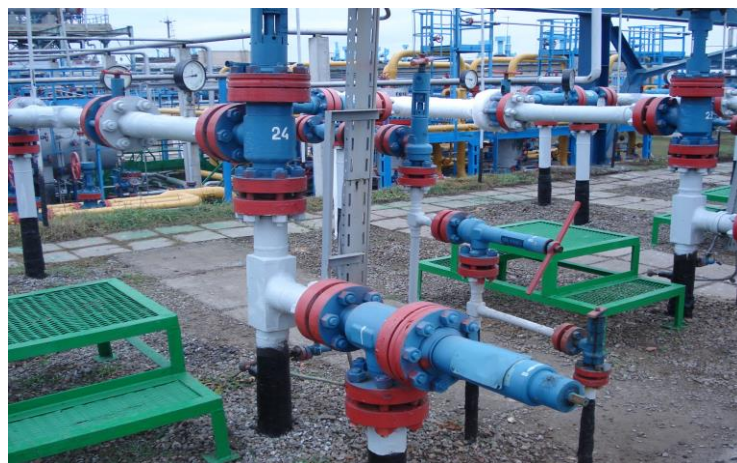
Рисунок 2.7 – Загальний вигляд обв'язки вхідного газопроводу установки від'єднувальних пристроїв та обмерзання трубопроводу
