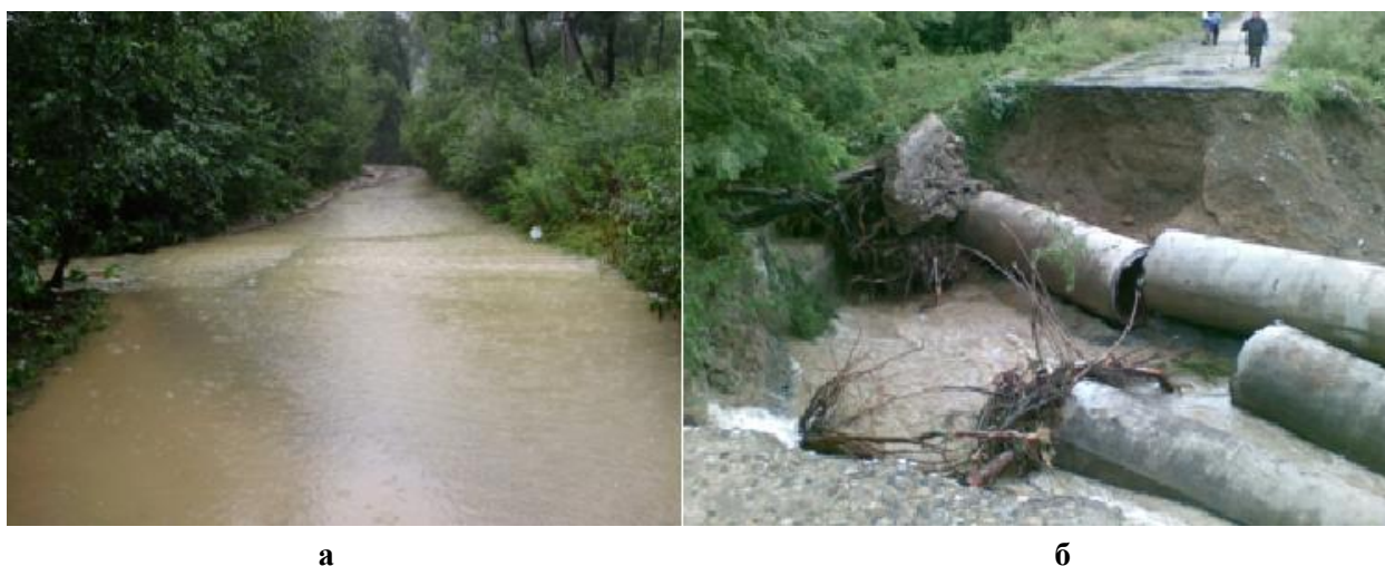
Рис. 9. Катастрофічний паводок 2008 р. на території Косівського району: а – розмита дорога Т 0913 Тюдів – Розтоки; б – зруйнований міст через р. Мала Лючка на автодорозі Т 0902 Яблунів – Делятин
