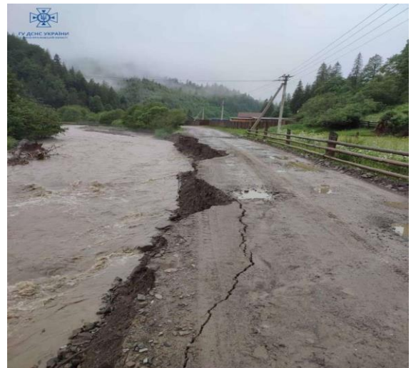
Рис. 1.4- Зруйнована ділянка автодороги Ільці–Буркут внаслідок зливових дощів, 16-17.06.2023
