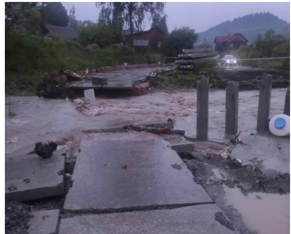
Рис. 1.2- Ділянка зруйнованої автодороги Турка-Східниця, 10.06.2023
