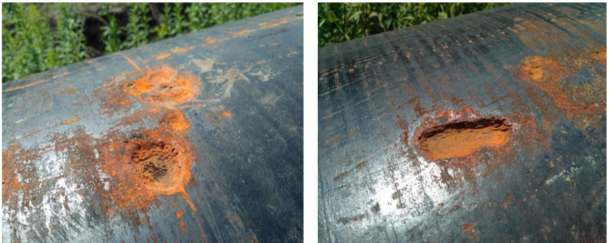
Рисунок 1.5 – Результати довготривалої експлуатації трубопроводів з дефектами корозійного походження
